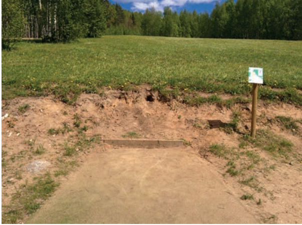
Foto 57. Tehvanid discgolfi pargi 2. raja viskeala, kus on probleeme erosiooniga. Autor: Argo Ingver
