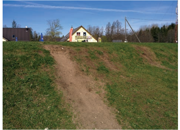
Foto 35. Kallaku peal tekkinud pinnasekahjustused. Autor: Argo Ingver
